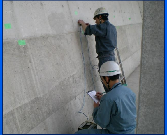
ひび割れ深さ測定
