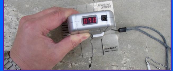
ひび割れ幅測定
